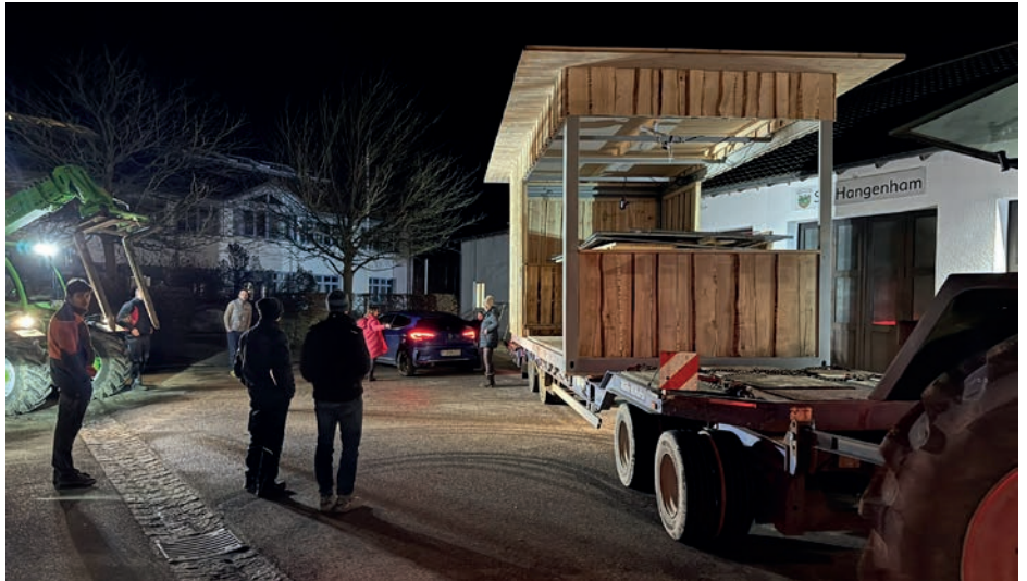
Schweres Gerät war erforderlich um die „Hütte“, eigentlich ein mit Holz verkleideter Containerrahmen, an Ort und Stelle zu bringen
